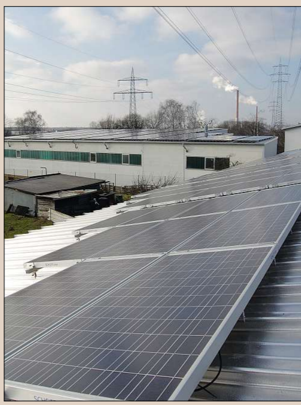
Fortschrittlich: Die Photovoltaikanlage auf dem Dach der Firma Heinrich Bollmann GmbH wandelt seit Dezember Solarenergie in Strom um.
