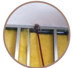
Unterbrechungen der Konstruktion gefährden die Statik einer Trockenbauwand.
