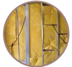
Man beachte die rechte Leitung über den Steg!!!
