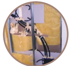
Unübliche Konstruktionen der Marke Eigenbau.
